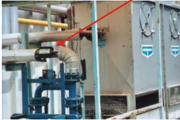
Aqua KLEAR So utma kulesi uygulaması
