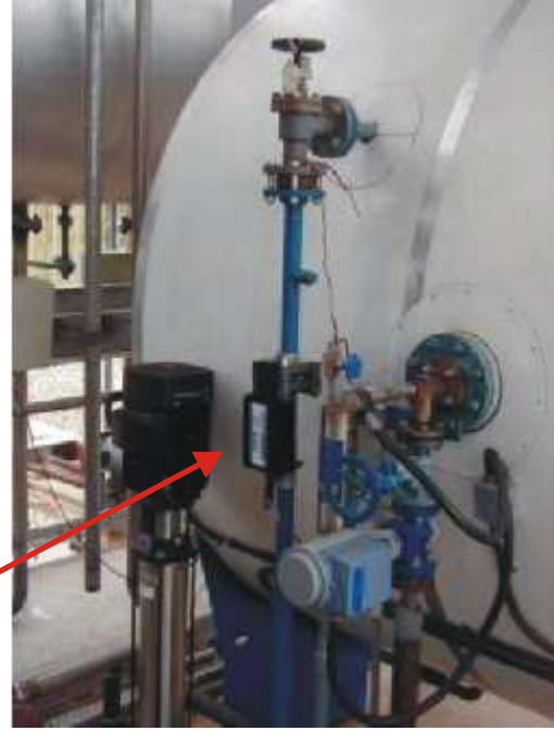
S- HydroFLOW buhar kazanı uygulaması
